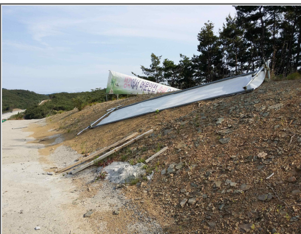
⑤ Sta.5+220부근(영천) 20m 소단 사면부 폐기물(안내판, 폐자재) 적치
