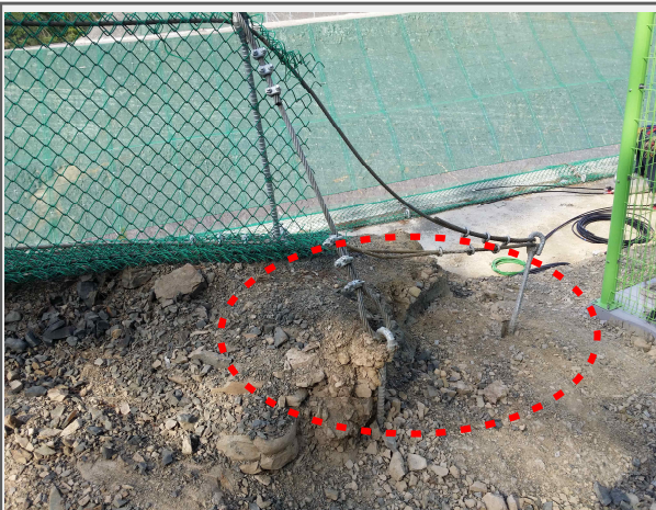
③ Sta.5+920부근(영천) 낙석방지망 설치 불량
