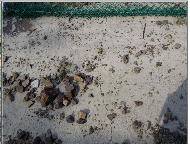
④ Sta.5+040부근(영천) 20m 소단 배수로 중방향 균열 발생(2개소)
